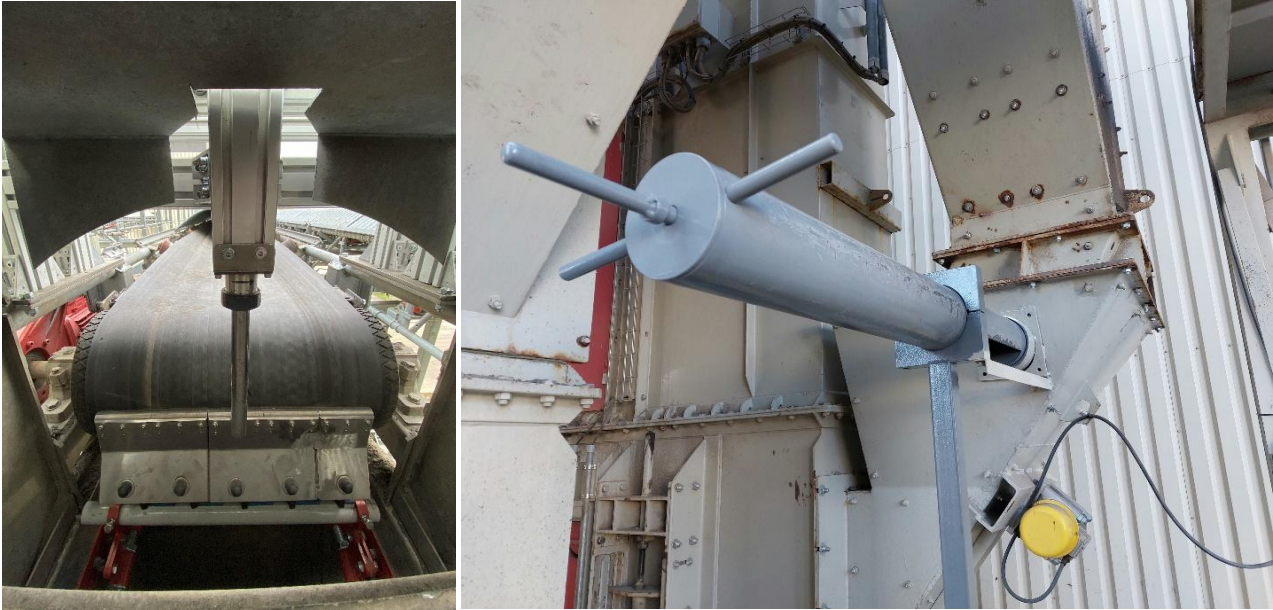
Abbildung 10. Installationsort des Online-Ansalyators und des Probennehmers
