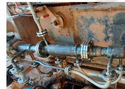
Inline-Zugabe: Entweder im Zulauf zur Bitumenwaage oder zwischen zwei Lagertanks
